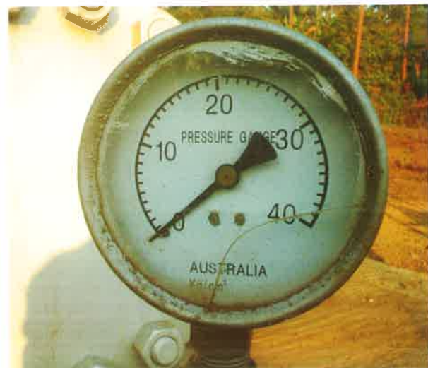
Gambar 5. TKS sumur Eksplorasi AT-1 Lapangan Panas Bumi Atadei, Kabupaten Lembata, NTT setelah Master Valve dibuka
